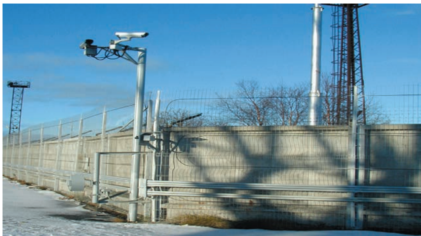
Рис. 4. Оборудование периметра объекта техническими средствами
